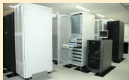
▲電子カルテシステムのサーバー群
